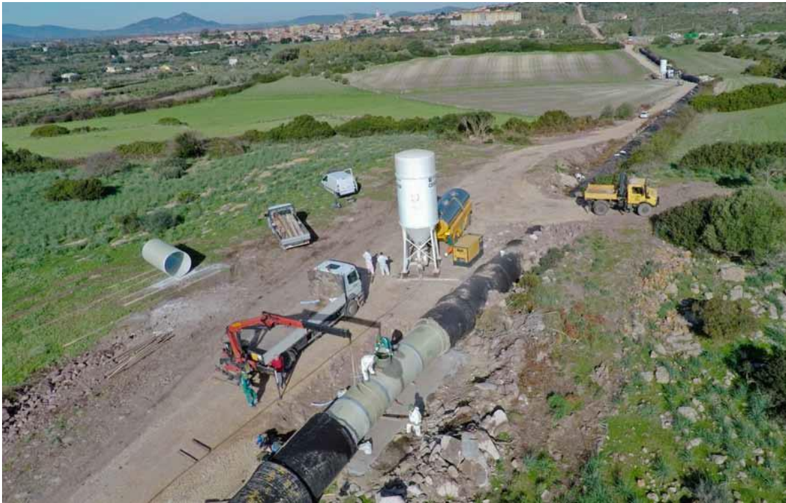
Legarea pieselor GRP confectionate in fabrica in fiecare groapa de constructii demonstreaza exactitatea planului de montare a tevilor.
